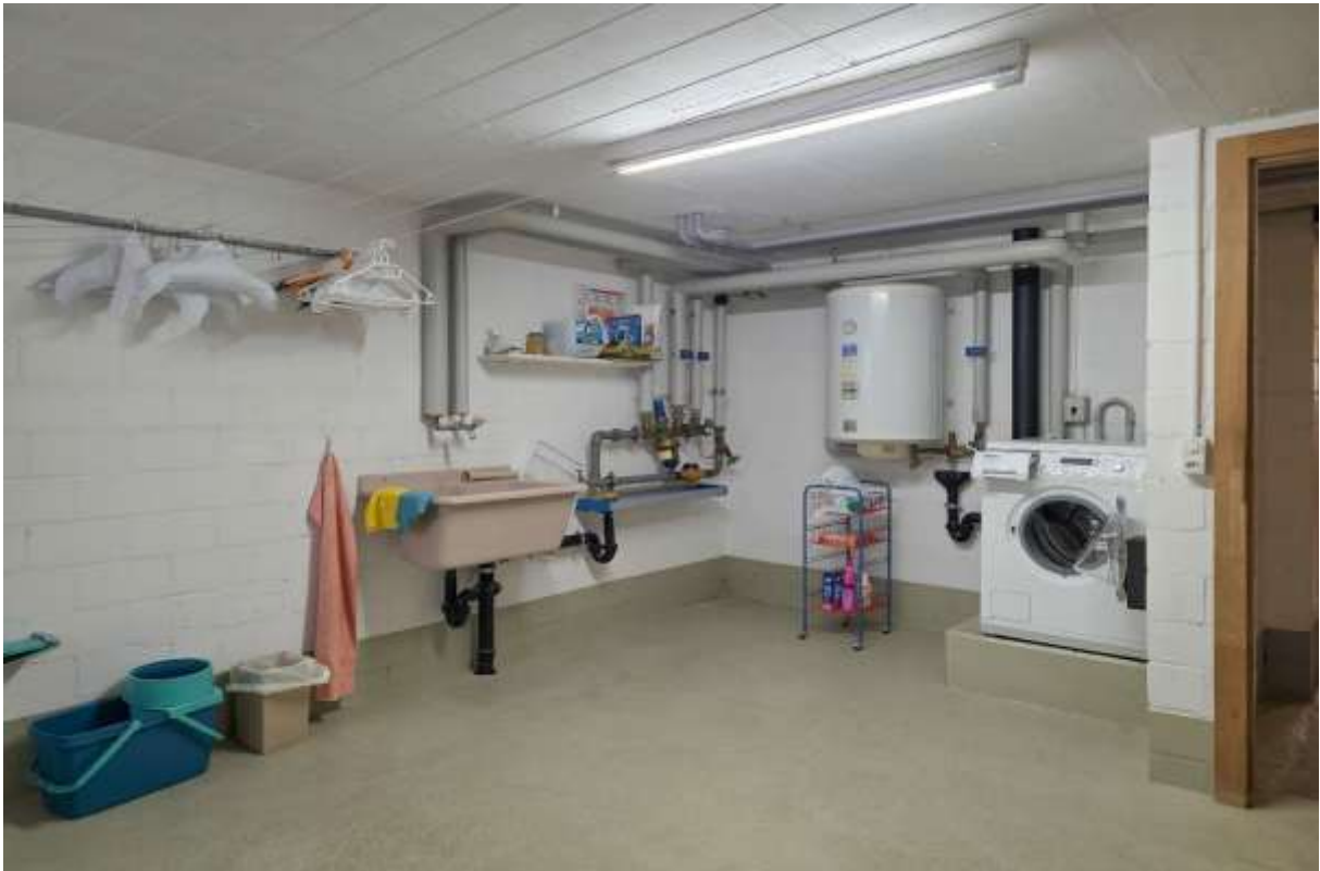
Die gemeinschaftliche Waschküche mit Waschmaschine und Handwaschbecken
