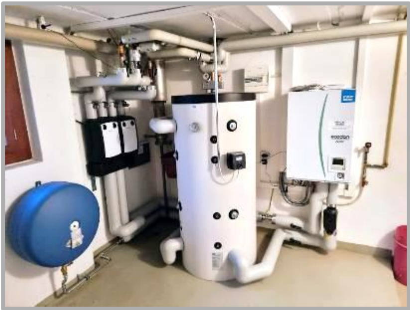
Neue Wärmepumpe in Betriebnahme 2024
