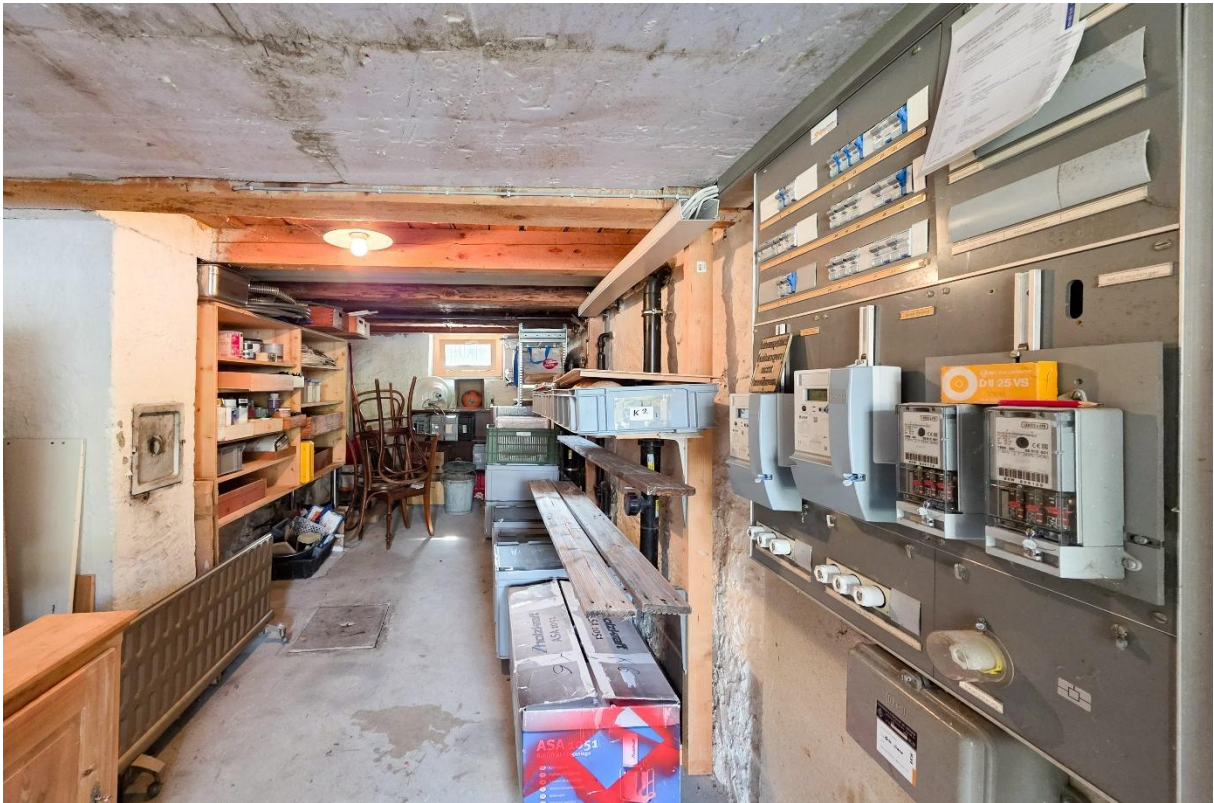
Kellerraum Nr. 2 mit Elektrotabelleau
